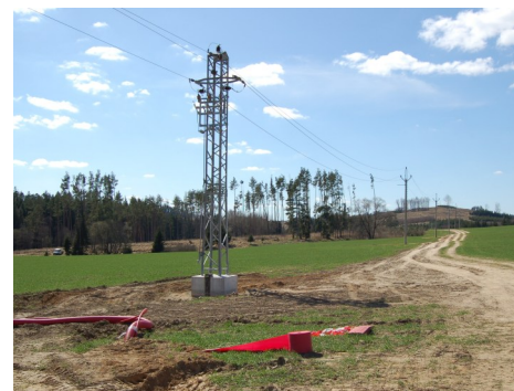
9. Uprostřed pole na Manových je kabel vyveden na poslední stožár trasy.
