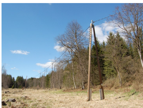
10. Kolem řeky Oslavy vede vysoké napětí do bývalého kamenolomu po dřevěných sloupech kabelem. Zde trasa rekonstrukce vedení VN v katastru Dolní Bory skončila.
